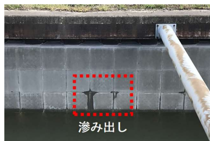
図2 パネル被覆工法のしみ出し状況
